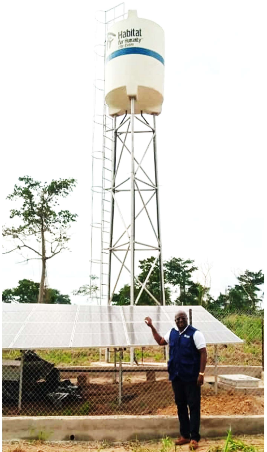
Dida N'Glossou – Toumodi Pompe solaire avec retenue d'eau Photo faite par le Service RD&C
